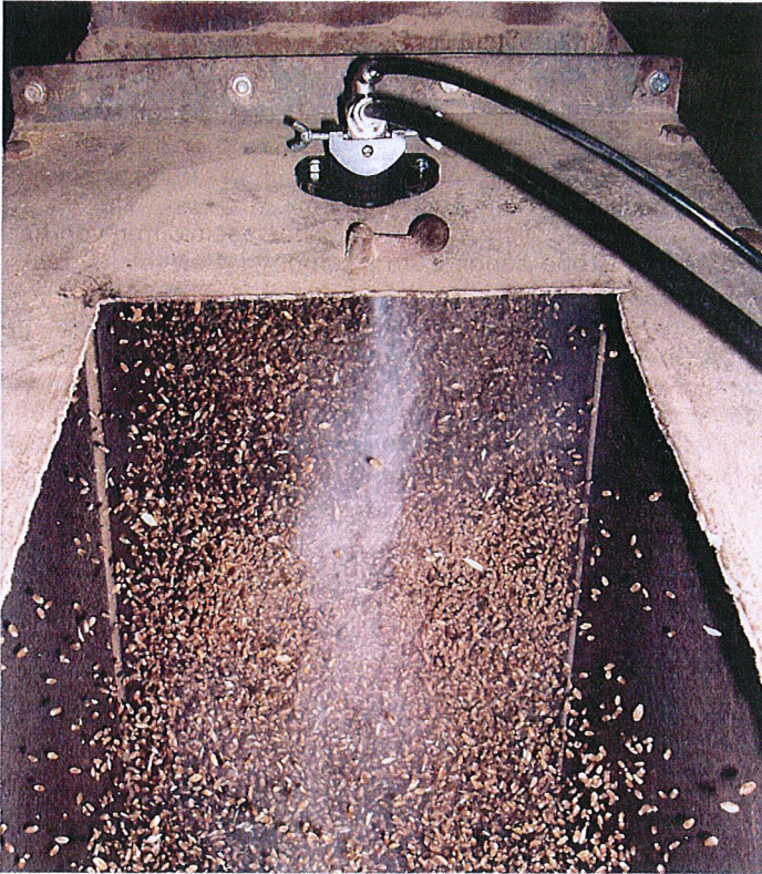
Abb. 2: Testbehandlung von Getreide im Kopf eines Elevators, hier ca. 50 t/h
